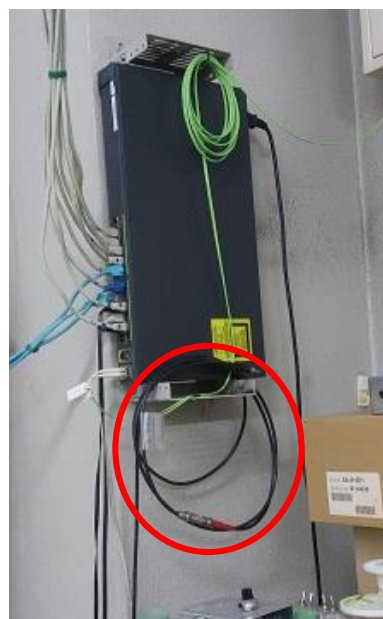
写真6 制御室内のケーブル
